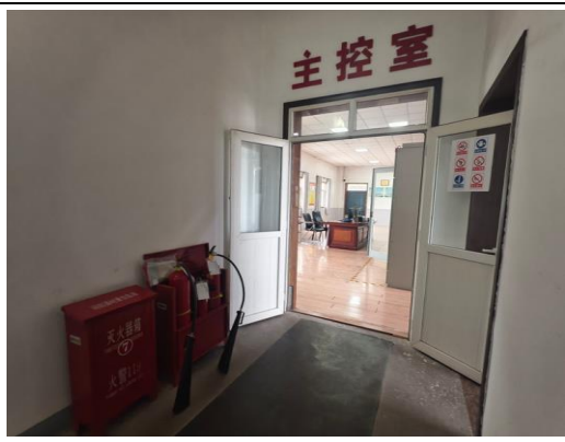
主控室消防设施
