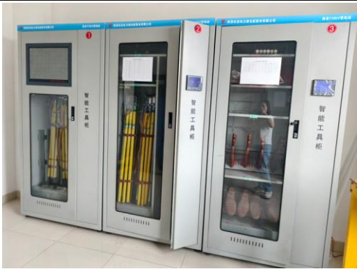
配电楼应急物资
