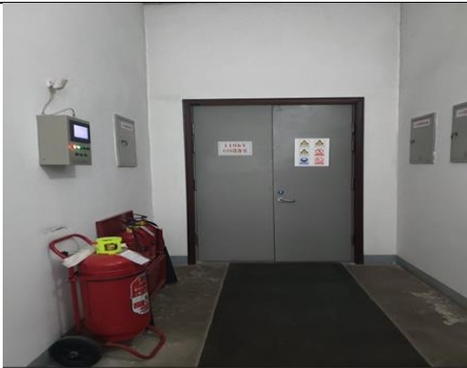
110kV GIS 设备室消防设施
