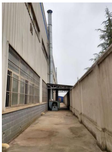
圆环链车间浸漆处理设施
